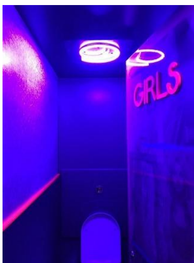
Figura 3 – Luzes azuis instaladas em banheiros públicos
